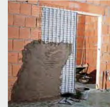
8. Una única capa de enfoscado será suficiente ya que el armazón se suministra preenfoscado.
